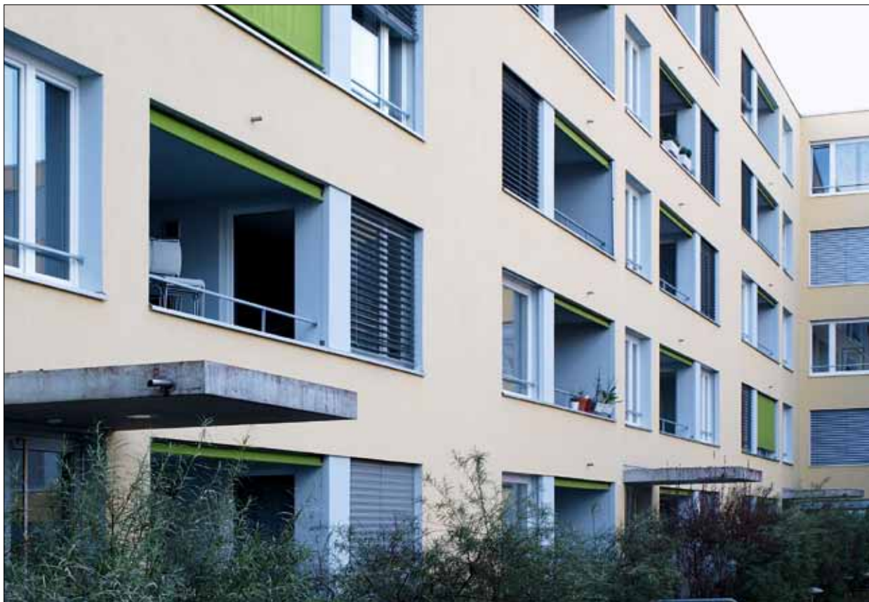
Dieses Wohnhaus in Kaiseraugst wurde den künftigen Mieterinnen und Mietern mit Minergie angepriesen. Doch es war gar keine Minergie drin.
